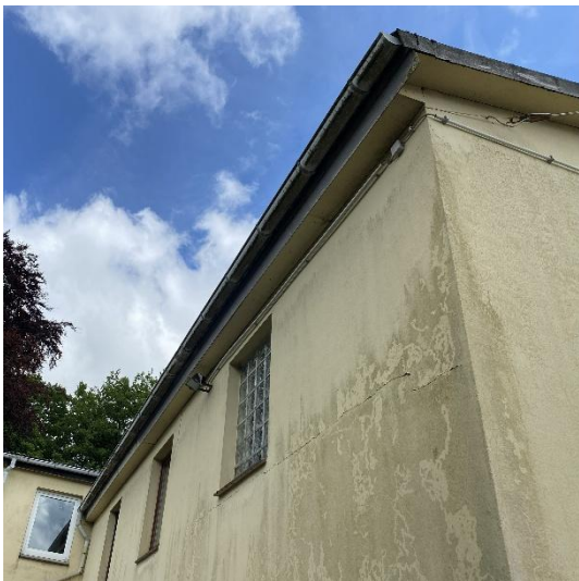
Abbildung 10.1.3: Anbau ohne Zugänge zum Dachstuhl (09.07.2025)
